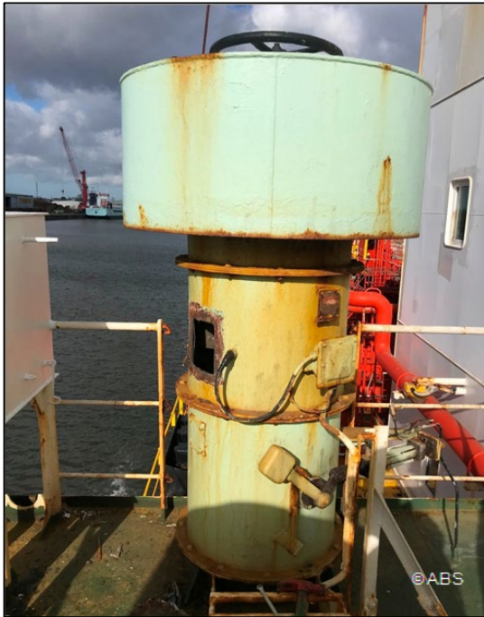
Inoperable ER ventilation fan damper
